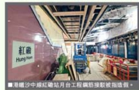
港鐵沙中線紅磡站月台工程鋼筋接駁位被指造假。
